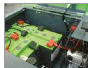
ALOJAMIENTO DE BATERÍAS (1250 E)
