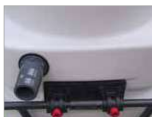
CONEXIÓN MANGUERA DRENAJE
