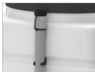
MANGUERA DE DRENAJE
