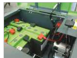
ALOJAMIENTO DE BATERÍAS (1280 E)
